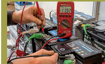
Überprüfung der Ruhespannung nach den jeweiligen Test-Durchläufen
